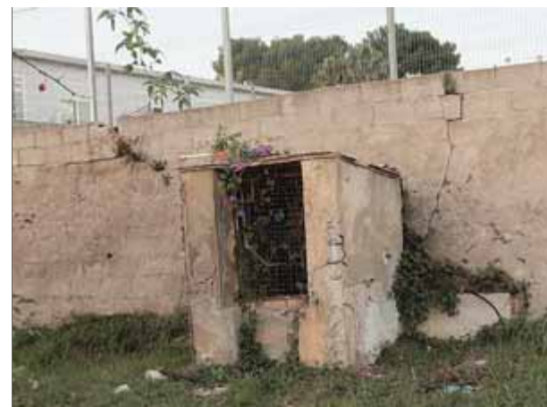
Esquerdes al mur de contenció del pati de l'escola ■ E.A.
